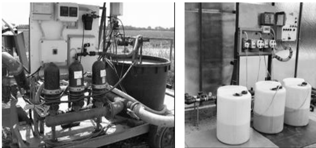
Figura 33 Particolare di gruppo di filtraggio e iniezione della soluzione nutritiva per la fertirrigazione in pieno campo e di contenitori per soluzione nutritiva concentrata in ambiente protetto
